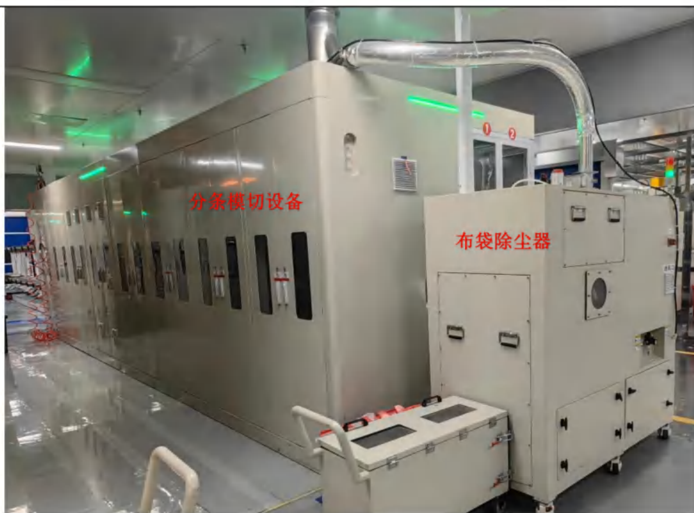
图 4-4 现有工程分条设备照片
