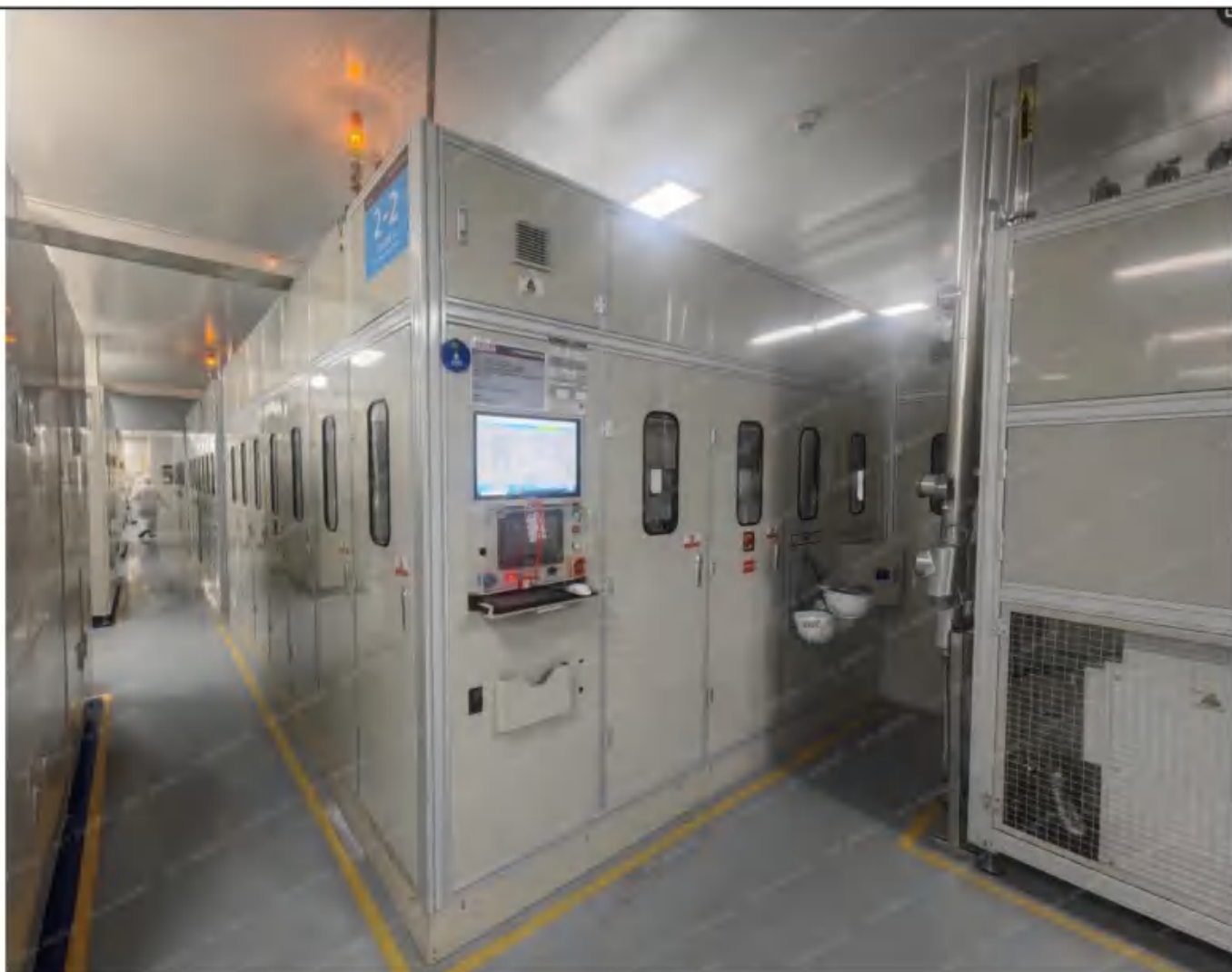
图 4-6 现有工程注液化成设备照片
