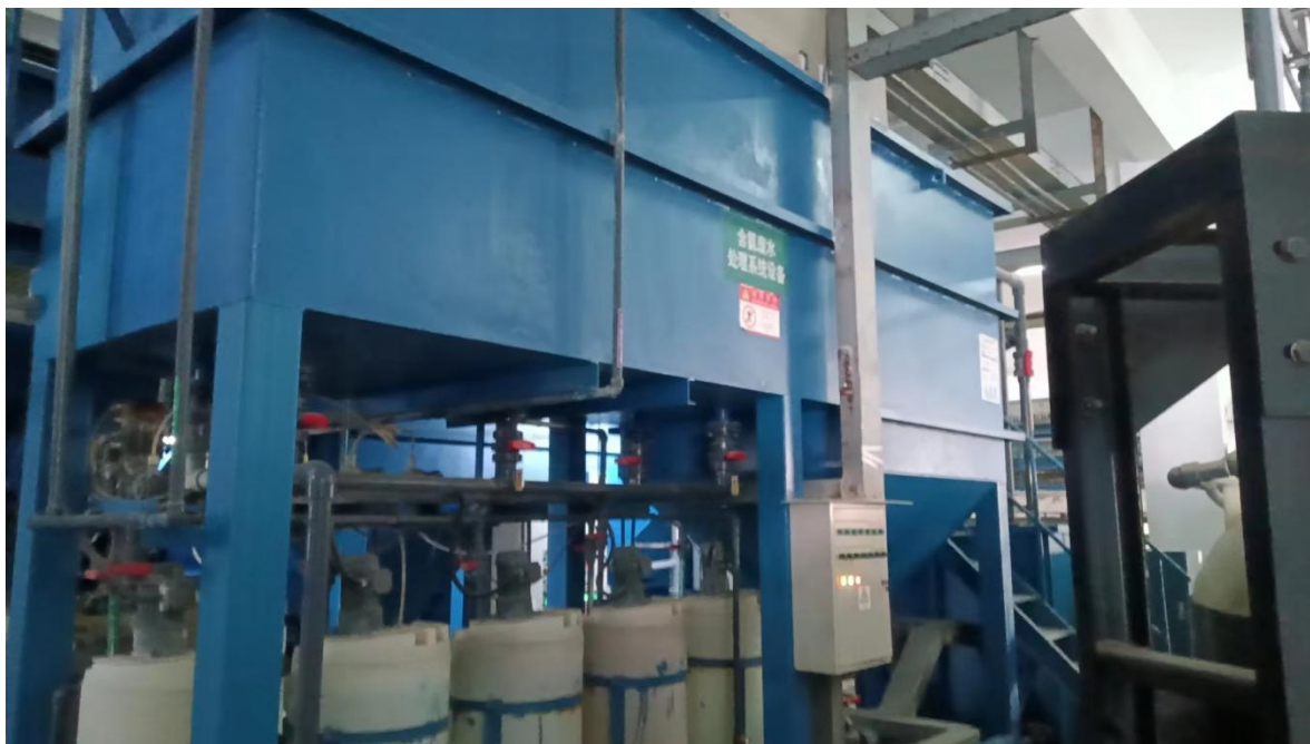
含氨废水处理站（同时处理含氨废水和含磷废水）
