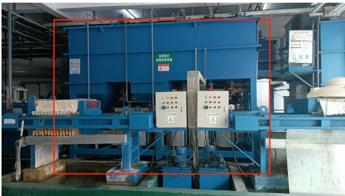
含磷废水处理站
