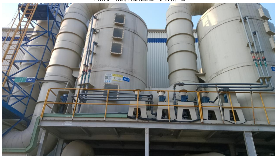
有机废气处理设施
