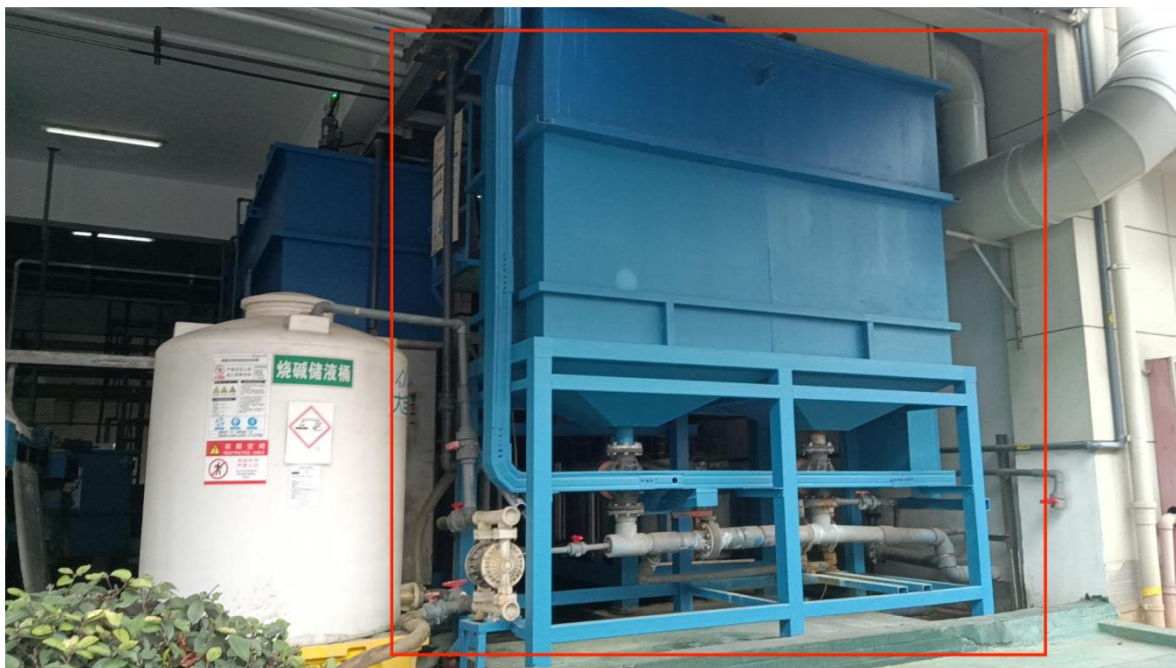
含氟废水处理站
