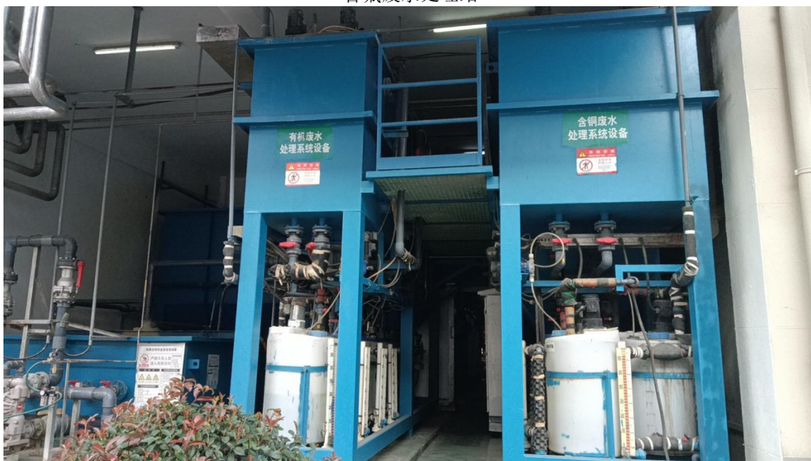
含铜废水处理站及有机废水处理站
