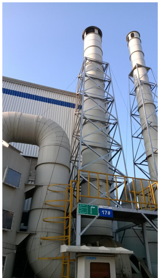
酸洗废气排气筒
