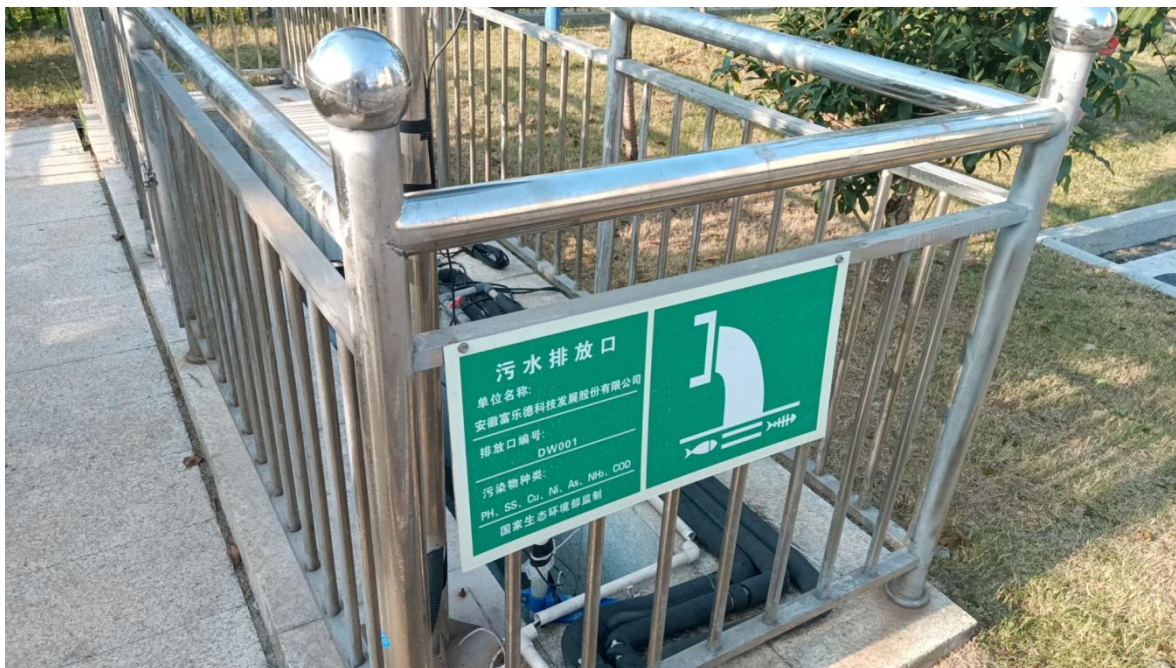
DW001 生产废水总排口
