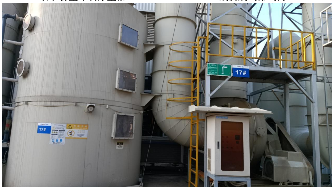
酸洗废气喷淋塔
