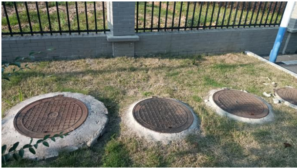
生活污水排放口
