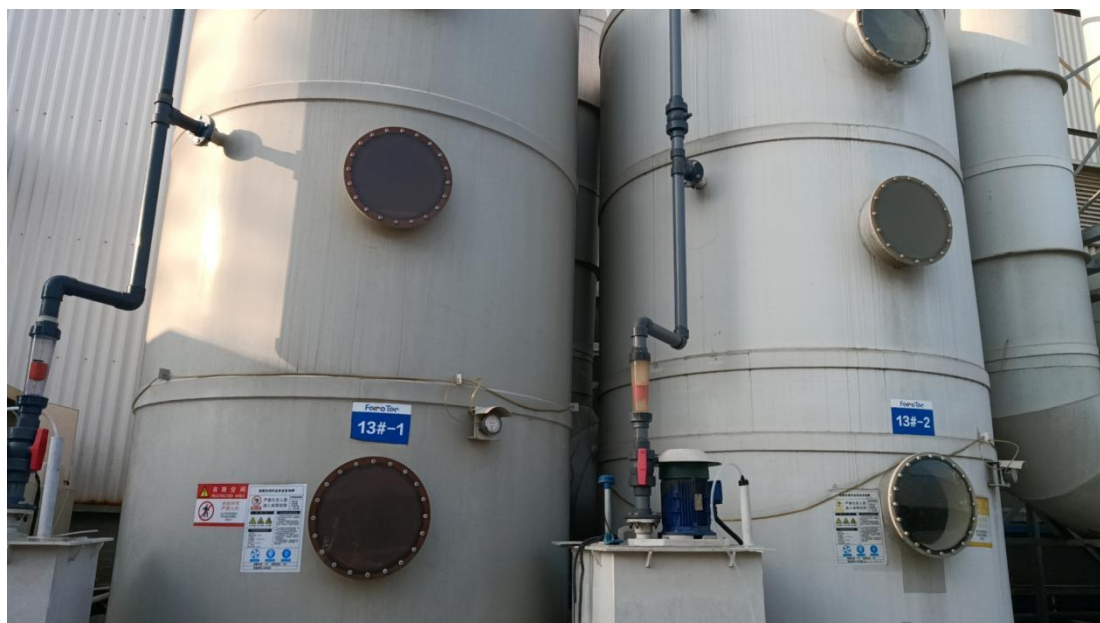
碱洗+氨水浸泡废气喷淋塔
