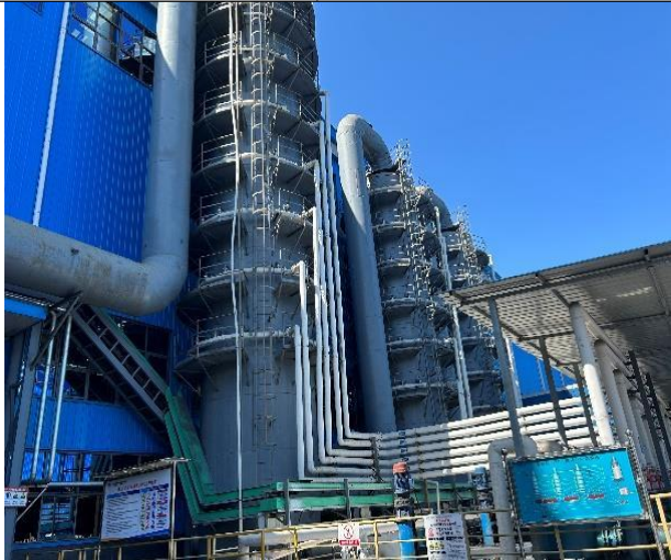
三级石灰石湿法脱硫装置（一车间）
