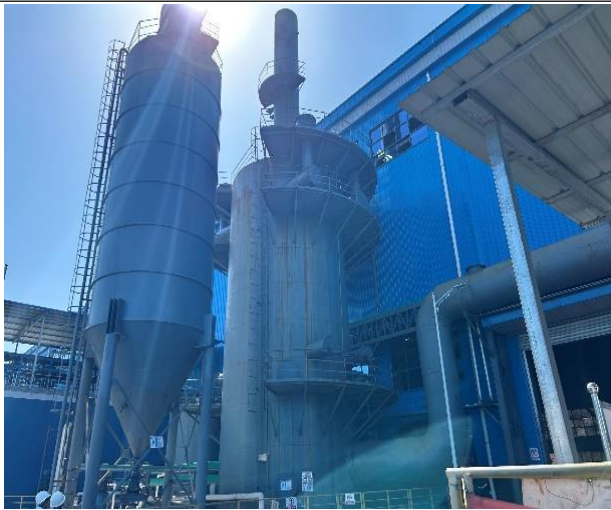
湿电除尘器+排气筒（一车间）
