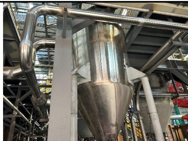
进料工序除尘器
