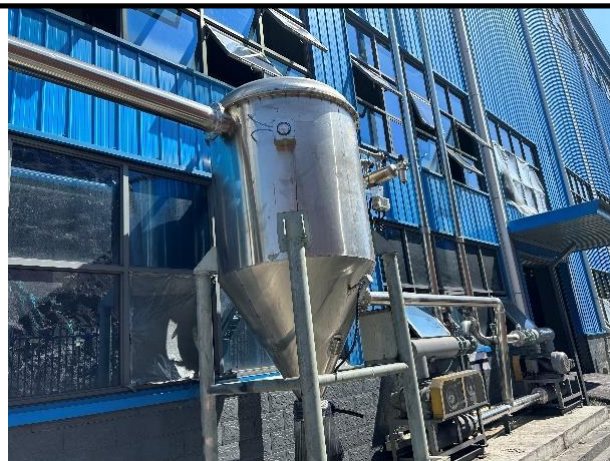
出料工序除尘器
