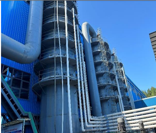
三级石灰石湿法脱硫装置（二车间）
