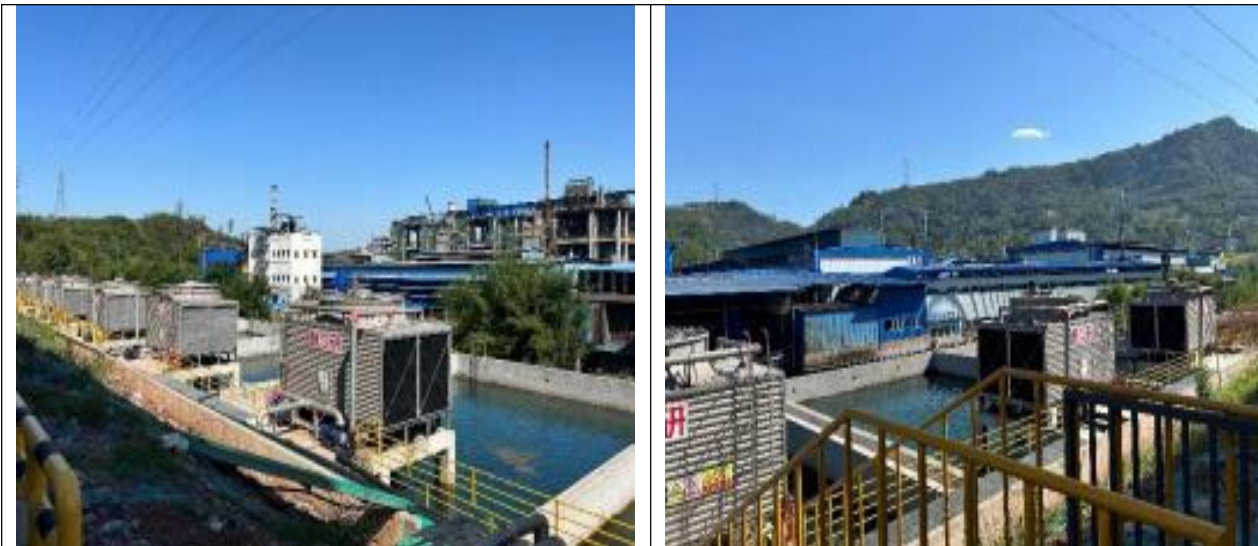
循环冷却系统排水沉淀池
